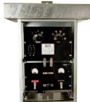
EQUIPAMENTOS RETIFICADORES PARA PROTEÇÃO CATÓDICA
